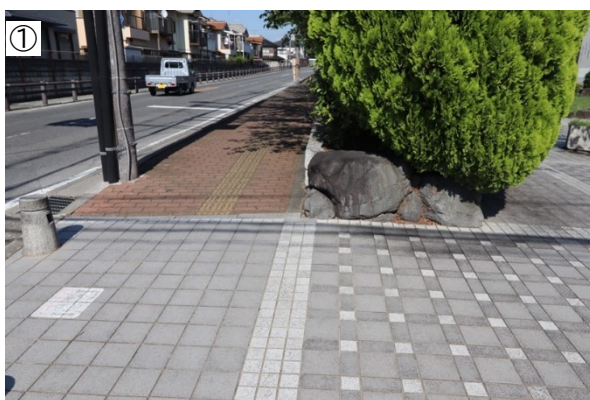
① ●誘導用ブロックが途切れている。
