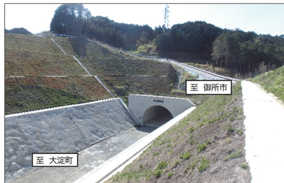
図：高取バイパス(高取トンネル/高取町清水谷)の整備状況 写真：奈良県「奈良県『都』づくり戦略2022」2022年(令和4年)2月
