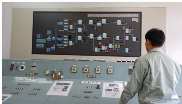
◆櫛羅浄水場の電気室(中央監視室)
